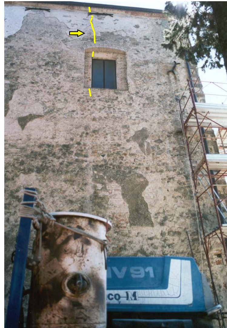
FOTO 10: parete laterale sinistra fascia di sovrapposizione con la facciata
