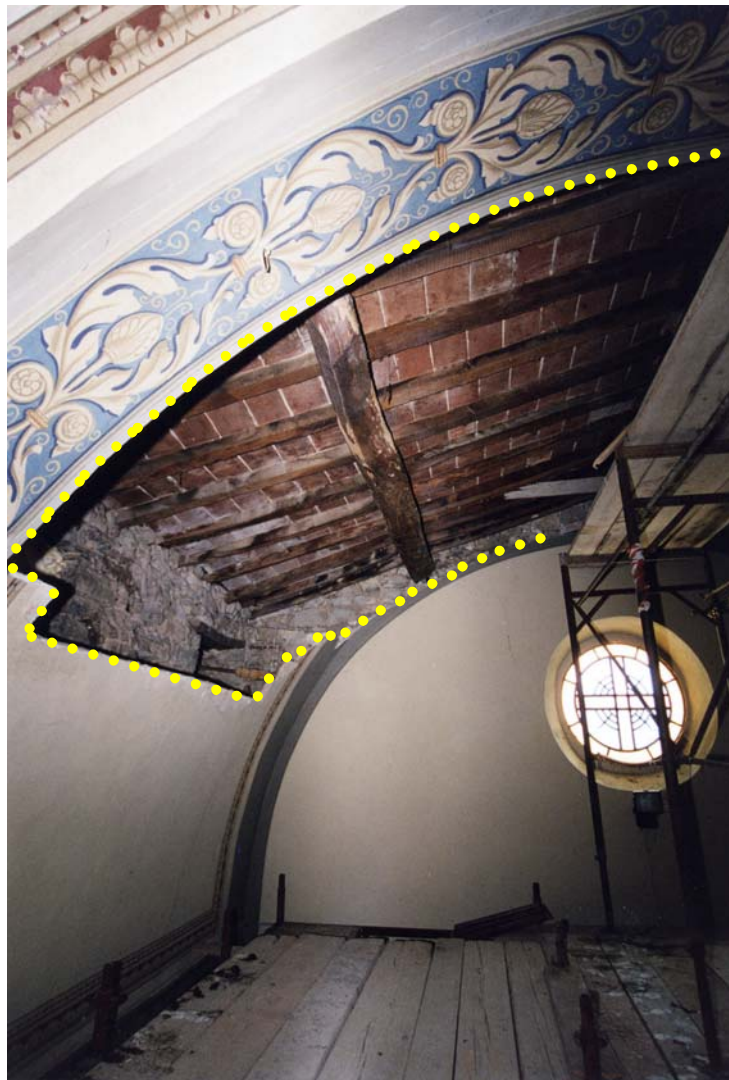
FOTO 11: volta nella campata prossima alla facciata - crollo
