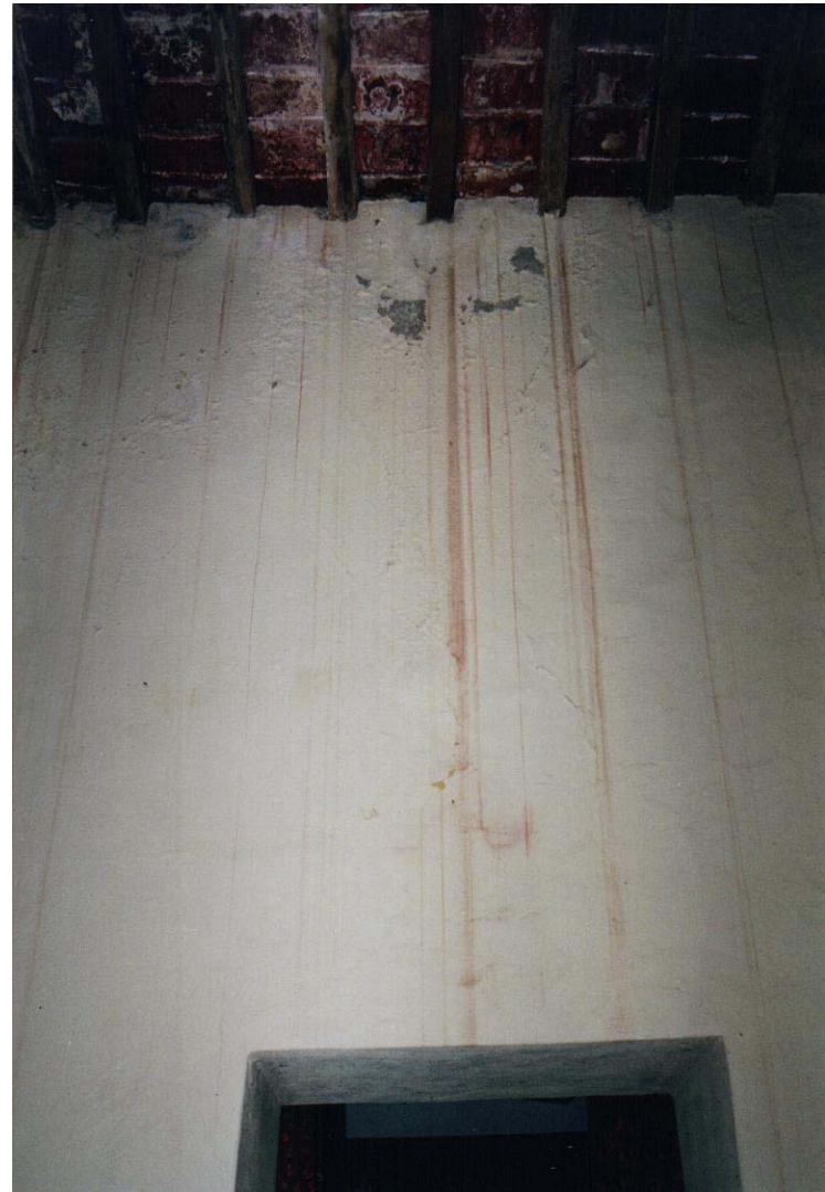
FOTO 15: copertura aula - infiltrazioni d'acqua
