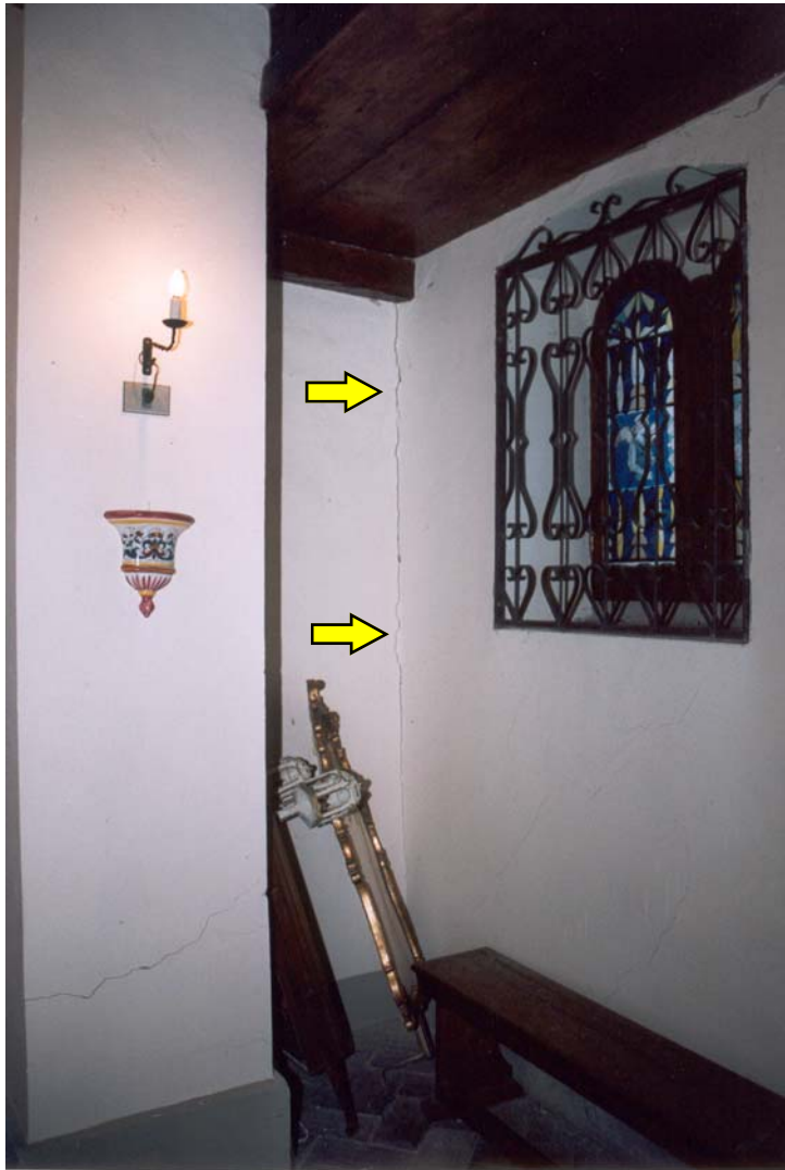
FOTO 27: fascia di sovrapposizione fra facciata E parete laterale destra - interno
