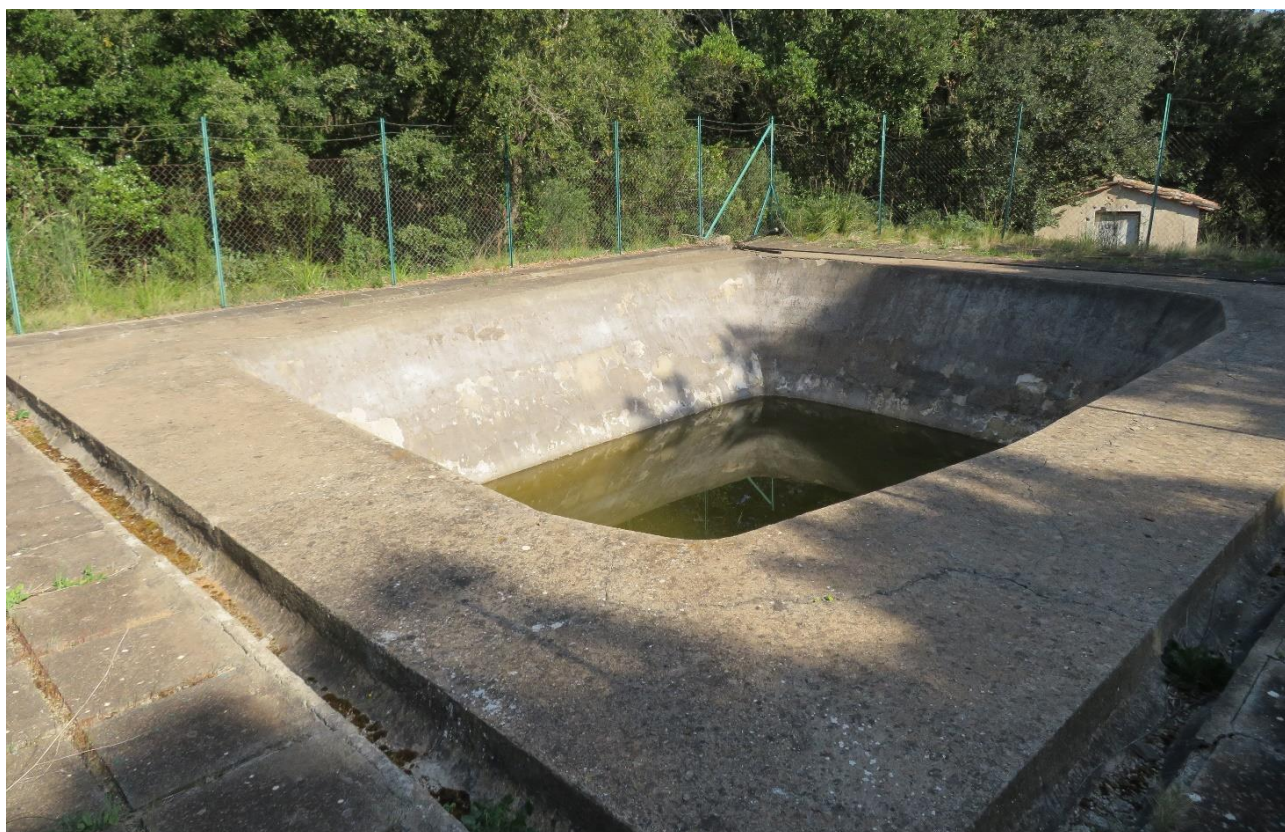
Figura 6.10 - Invaso AIB presso lo Sgozzatoio.
