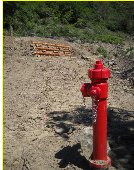
Figura 6.26 - Idrante lungo il viale parafuoco AIB.
