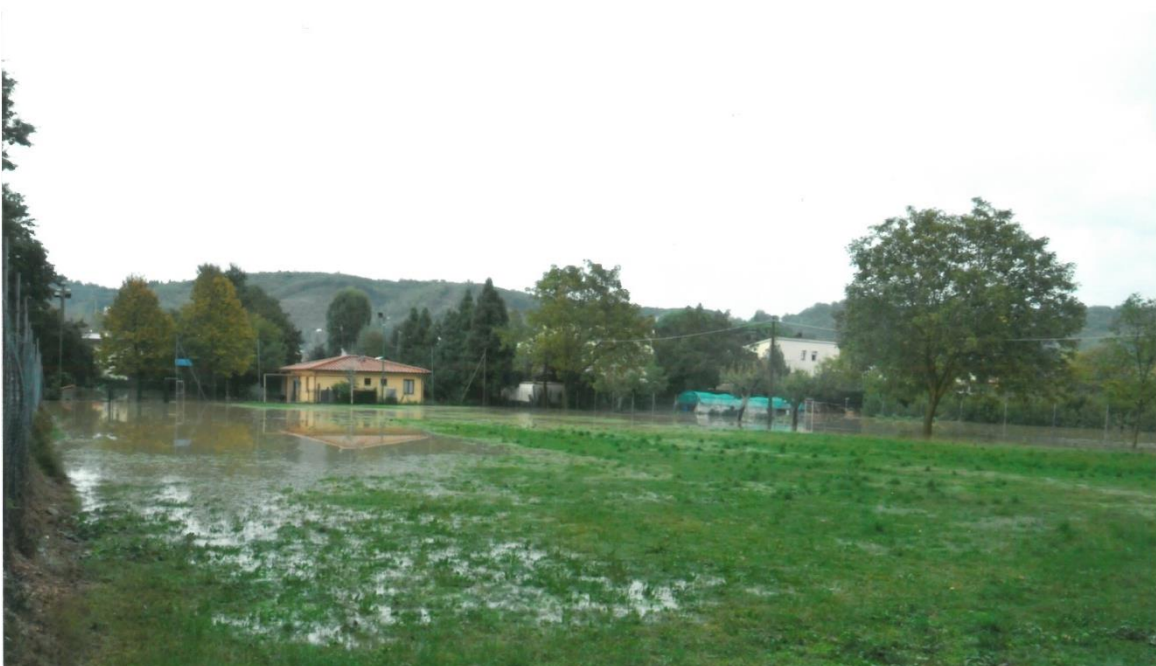
Figura 2-9: allagamento dell'area in cui sarà realizzato il tratto del nuovo canale di acque basse a monte dell'attraversamento del T. Valtina (evento 27-28 luglio 2019).
