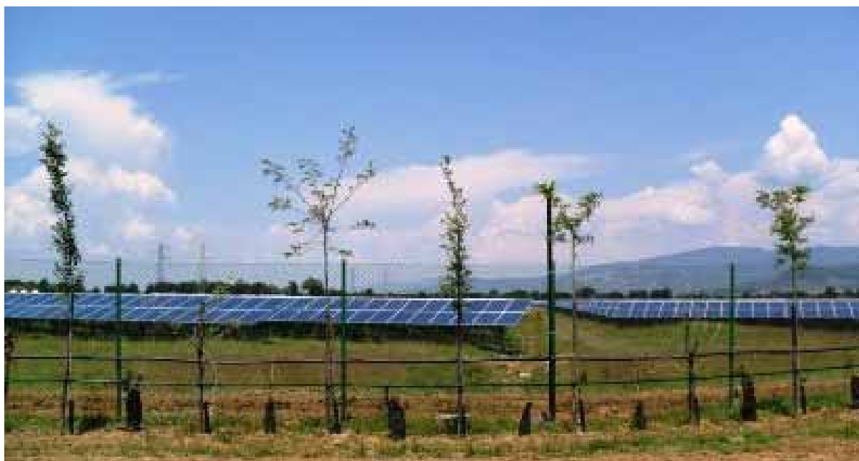
Il parco fotovoltaico di Malalbergo
